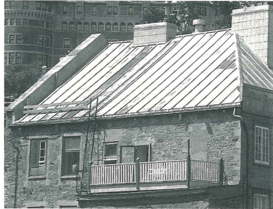
Des tôles soulevées ou la présence de rouille sont des signes de faiblesse du revêtement de la toiture.
