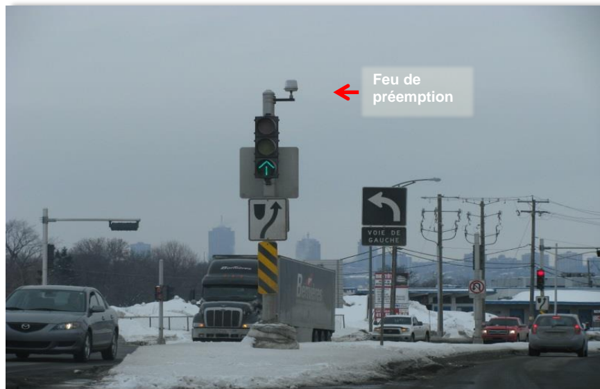
Feu de préemption installé à l'intersection de l'autoroute Robert-Bourassa et du boulevard Wilfrid-Hamel
