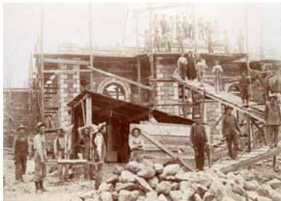
Reconstruction de l'église de Beauport incendiée en 1916. Société d'art et d'histoire de Beauport, fonds Marie-Paule Parent.
