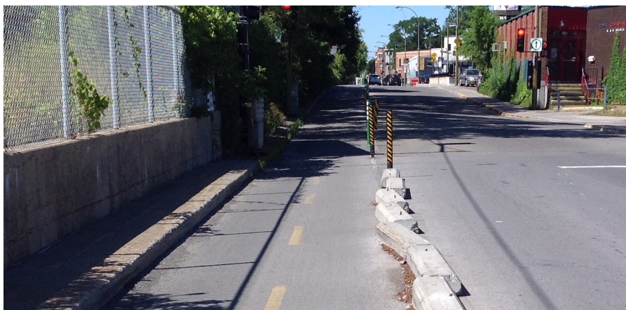
Figure 11. Segments de bordure préfabriquée désalignés
