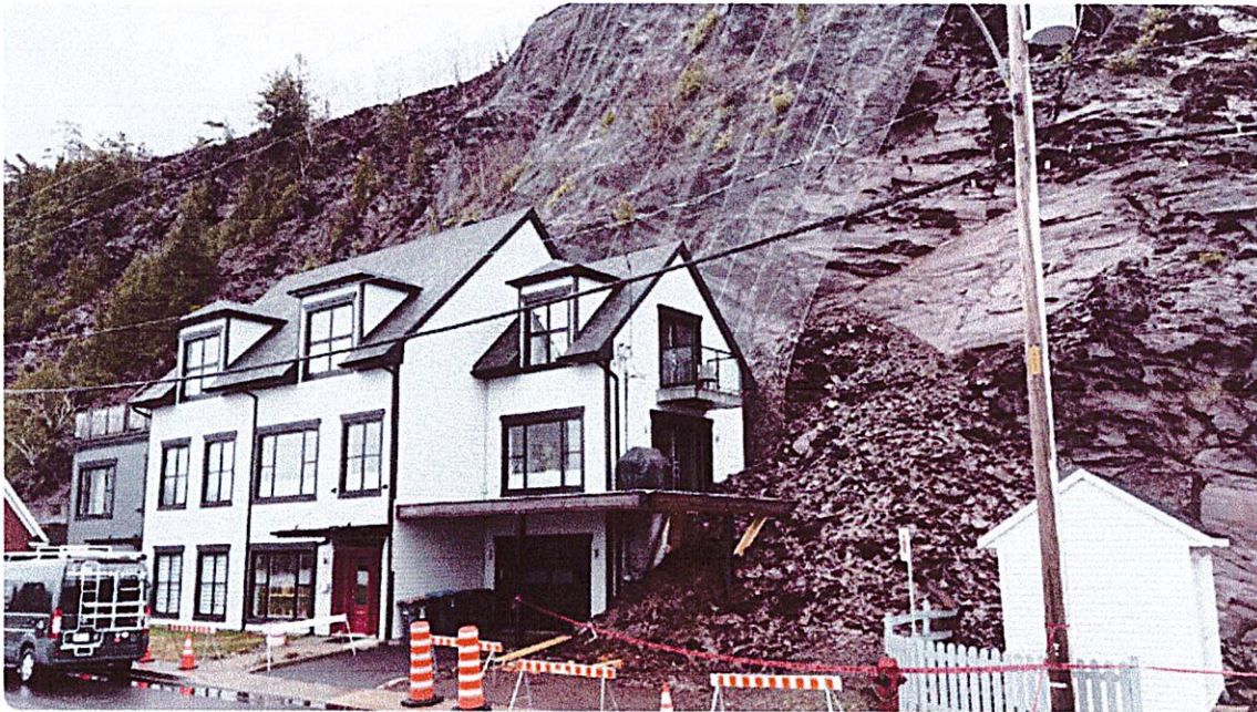
Le bâtiment touché par l'éboulement abrite un triplex, mais la grande quantité de roches s'est principalement dirigée vers le 4174, rue Saint-Laurent.
